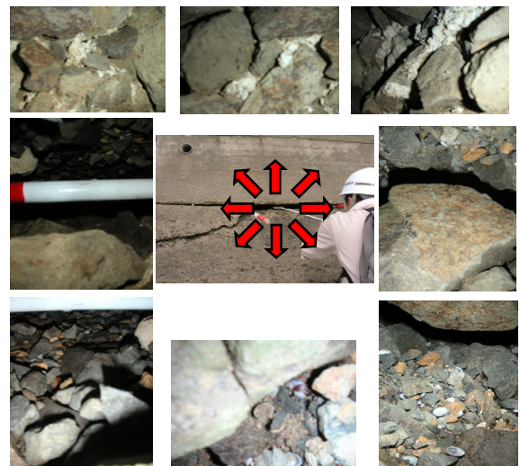
写真-3 空洞撮影写真
