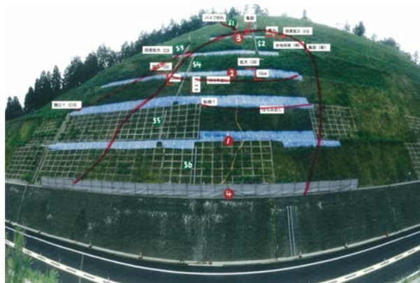
写真-1 変形進行後の全景。図中の線は変形範囲および変形進行が顕著な小段。中心付近の丸はボーリング位置。
