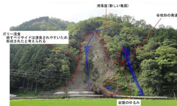
写真-1 崩壊の写真
