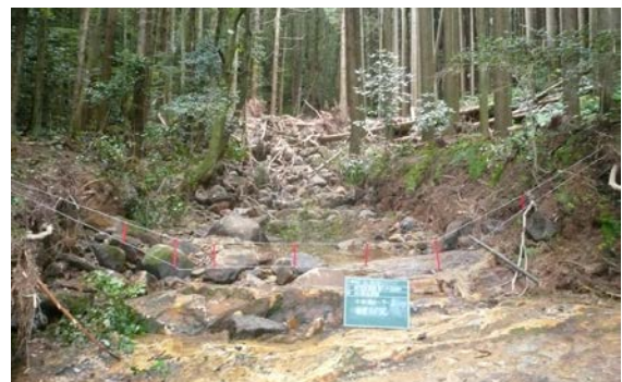
写真-2 土石流センサー設置状況
