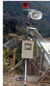
写真-4. 現場用無線警報機
