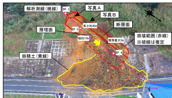
写真-1 崩壊箇所全景
