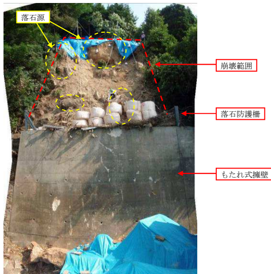
写真-1 崩壊現場
