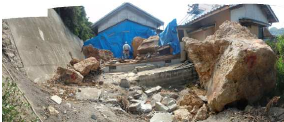
写-4 落下岩塊(写-3の直角方向)
